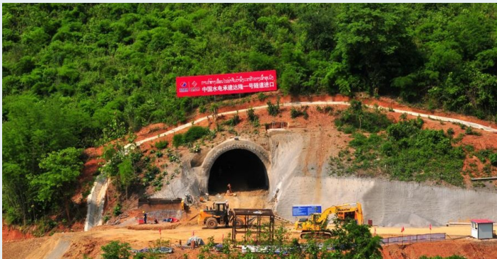
ການເຈາະອຸມົງເສັ້ນທາງລົດໄຟລາວ-ຈີນຢູ່ແຂວງຫຼວງພະບາງ, ປະເທດລາວ. ພາບໂດຍ ຊິນຫົວເນັດ
